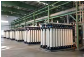
亚太森博城市中水再处理回用项目
