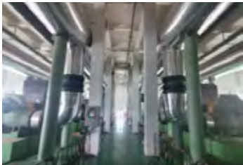
亚太森博烟气治理与余热供暖一体化项目
